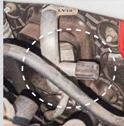
Engate da linha de baixa – terá diâmetro menor e/ou tubulação de diâmetro maior
